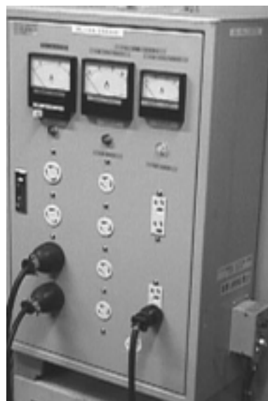
図 3.5.1 実験盤。写真右隅に付いているのが漏電検出器。
